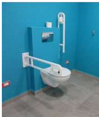
Inodoro con pulsador de emergencia.
